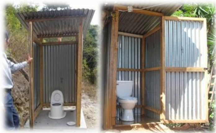
FIGURA 39. Letrinas de Pozo Ciego Ventilado y Letrinas Lavables instaladas en 23 comunidades, ubicadas en zonas de recarga hídrica.
